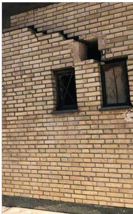
فرونشست زمین/ دیوار ساختمان یک مدرسه در اصفهان
